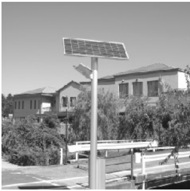
太陽光パネルの防犯灯
