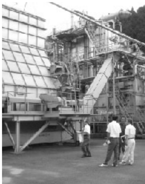
白川町バイオマス発電所
