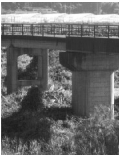
老朽化した橋桁
