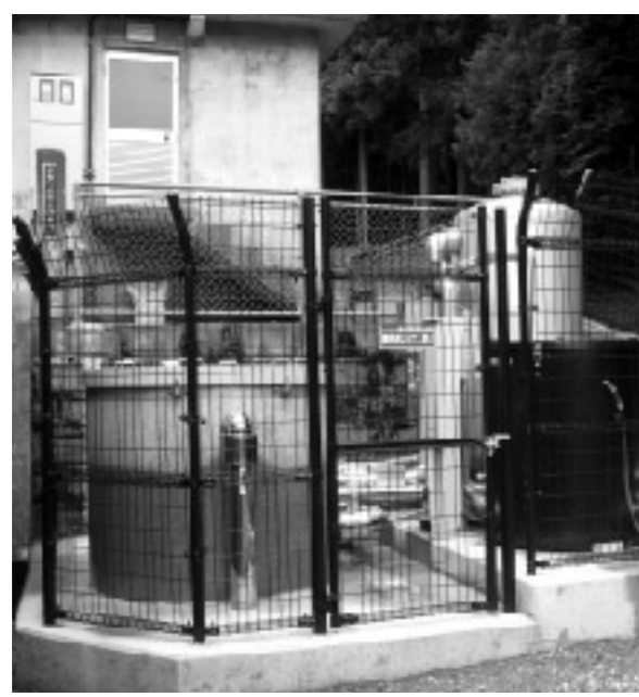
南後谷浄水場(硬度処理施設)
