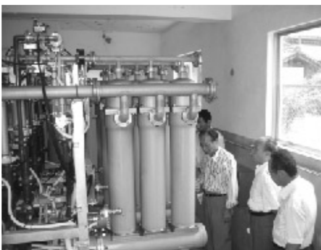
上水道新ろ過施設(川相)
