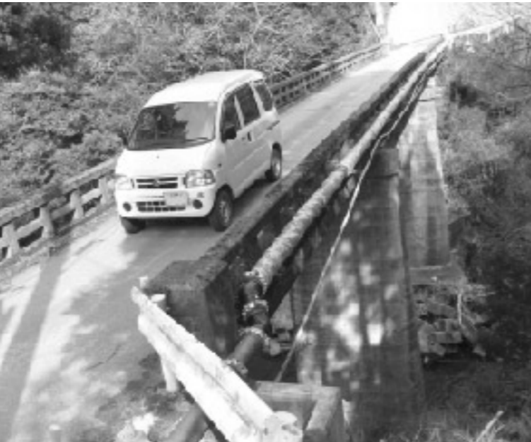
修繕計画が待たれる仏ヶ後の老朽橋
