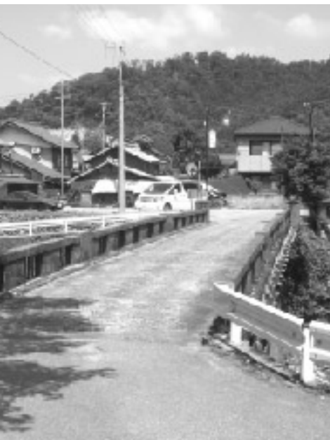
老朽化が進む一ノ瀬橋
