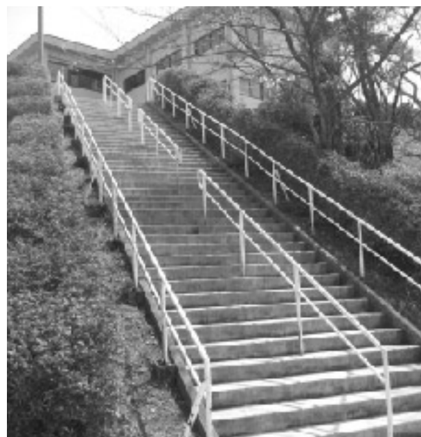
危険がともなう階段(多賀中学校)
