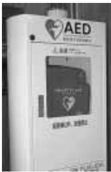
▲役場入口ホールに設置されたAED
